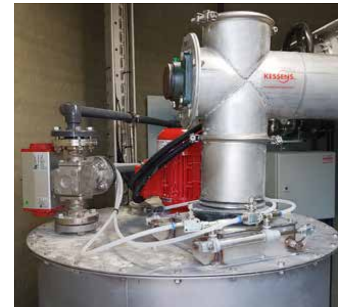
Eindosierung in den Mixtank
