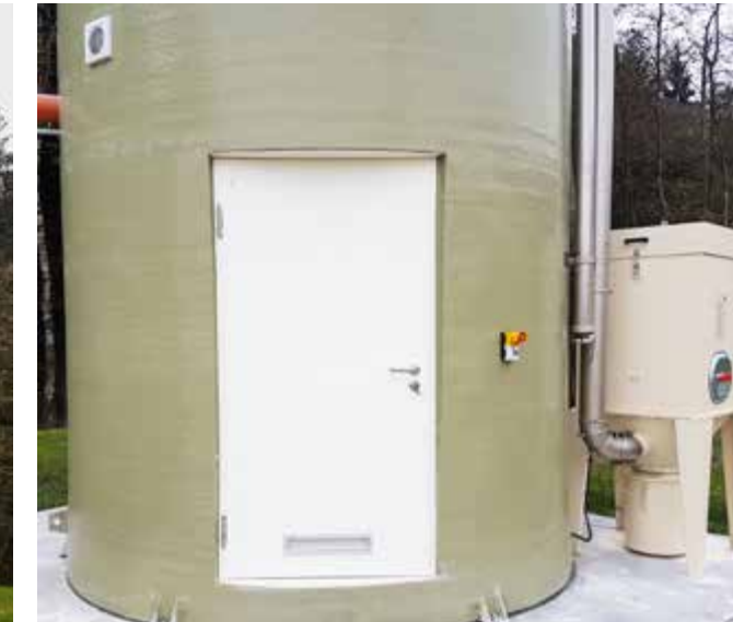
GFK- Silo mit isolierter Standzarge, Abluftfilter
