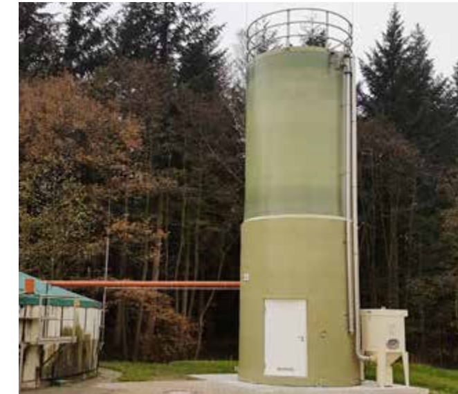
Gesamtansicht des Flüssigdosiersystems
